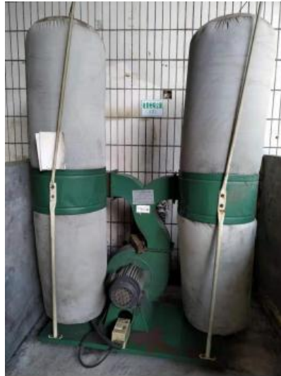
图3.4.7研磨粉尘除尘设施图
